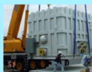
Four-stack module 1.4 MW
